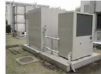
貯湯槽とHP温水器
