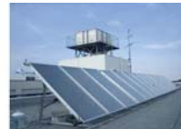
太陽集熱器(5号館屋上)
