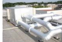
デシカント空調機(5号館屋上)
