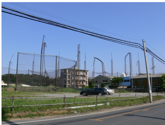
ゴルフ場ネットを支える鉄塔の被害
