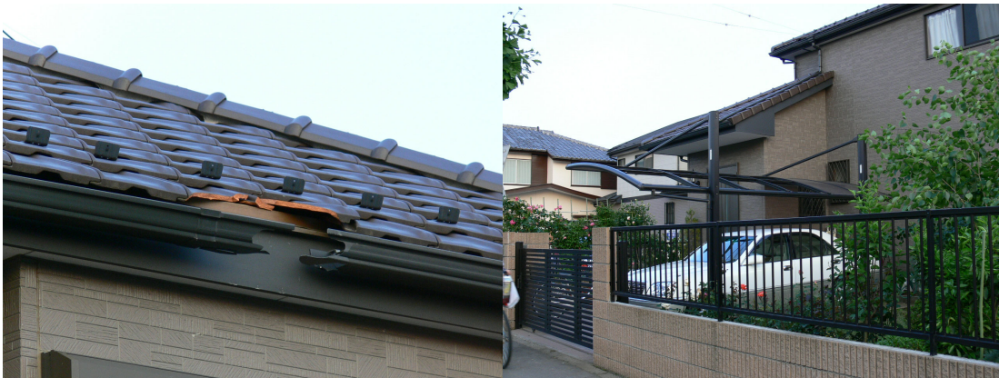
飛来物による屋根葺材の被害
