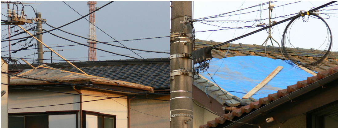
屋根葺材の被害
