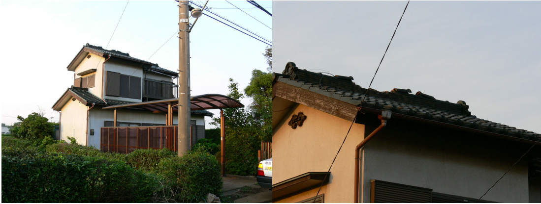
屋根棟瓦の被害
