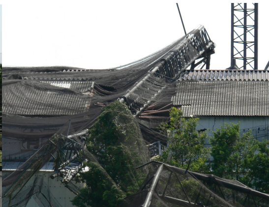
同，工場屋根の被害
