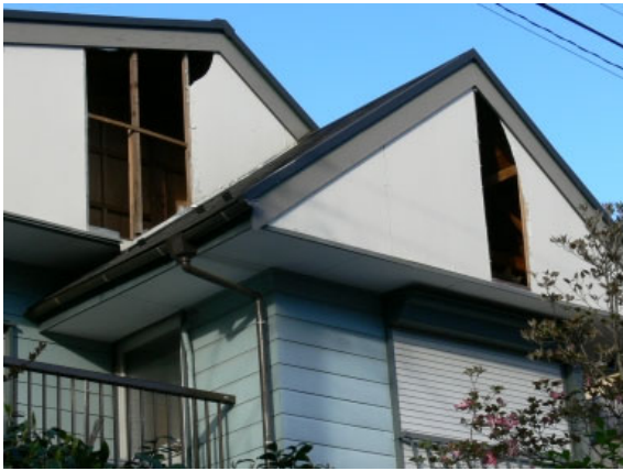
住宅の南西側壁面外壁の損傷
