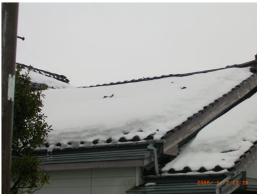
地点3 榎木地区における棟瓦の被害
