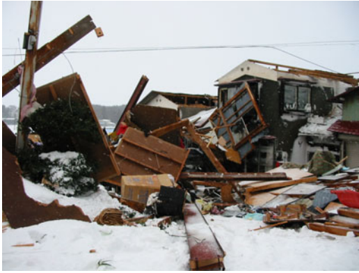
大沢地区の木造2階建事務所の倒壊 (峰浜村役場提供)
