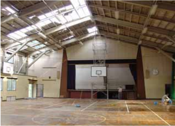
風上側屋根の葺き材が飛ばされた。
