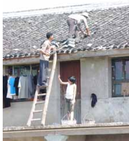
屋根瓦の被害
