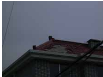
屋根瓦の飛散
