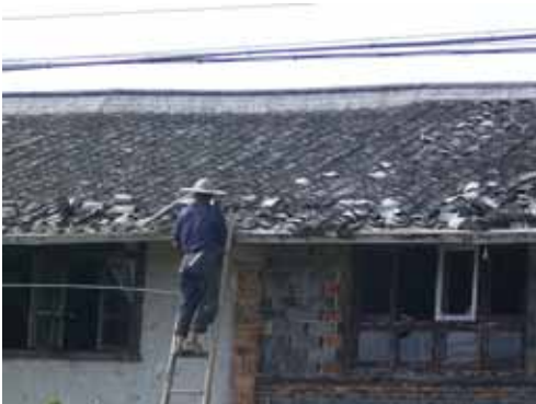
屋根瓦の被害
